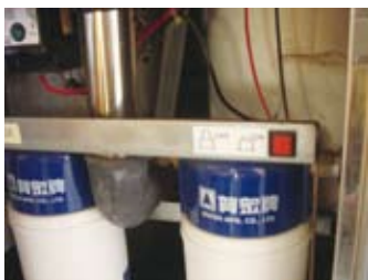
飲水機安裝定時器
