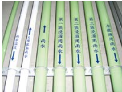
雨水管線標示
